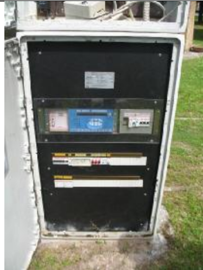
Figura 11 - Quadro Q17 - Regolatore di flusso
