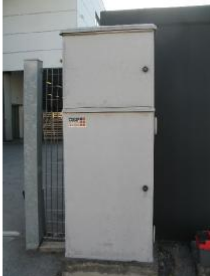
Figura 13 - Quadro Q23 - Vista esterna
