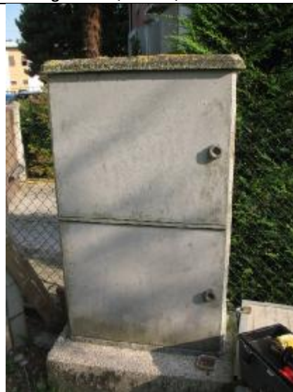
Figura 6 - Quadro Q33 -Vista esterna
