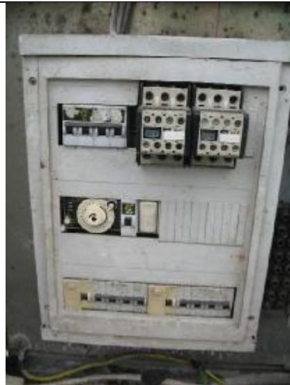
Figura 4 - Quadro Q01 vista interna
