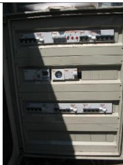
Figura 8 - Quadro Q36 - Vista interna
