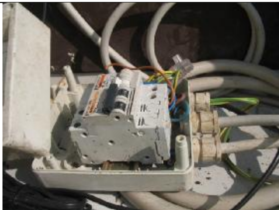
Figura 12 - Esempio di conduttore di protezione non collegato all'impianto di terra
