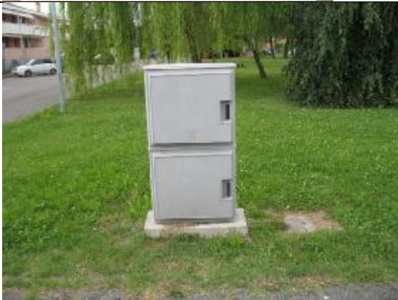
Figura 3 - Quadro Q01 Vista esterna
