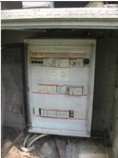
Figura 5 - Quadro Q33 Vista interna
